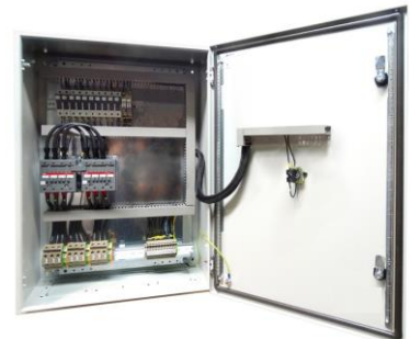
INVERSEUR DE SECOURS
