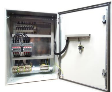
INVERSEUR DE SECOURS
