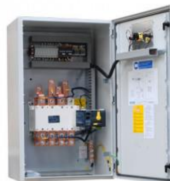
INVERSEUR DE SECOURS
